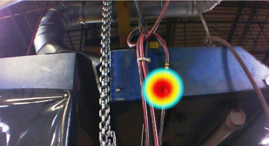
ii900 Endüstriyel Akustik Görüntüleme Cihazı ile çekilen görüntüde, endüstriyel bir ortamdaki hava sızıntısı yer almaktadır.
